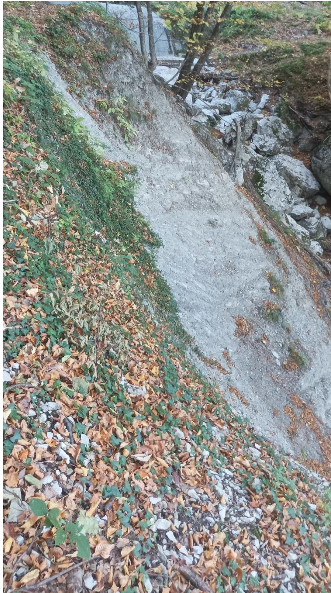
Figura 113 – Erosione diffusa del versante sul quale passa il sentiero
