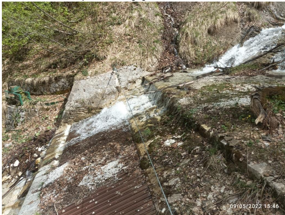
Figura 24 - OP San Vittore 1 dettaglio della griglia e del materiale accumulato
