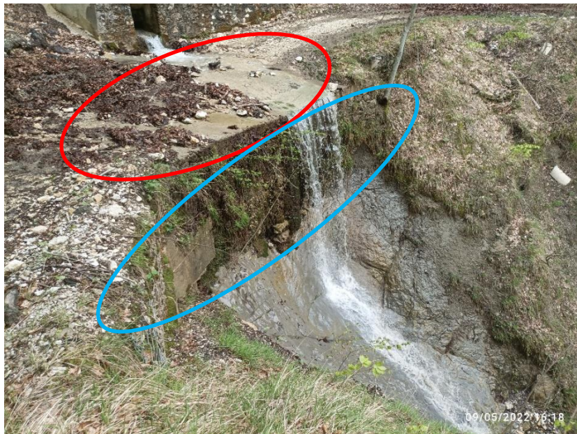
Figura 67 - Ellisse rossa: soletta da demolire. Ellisse ciano: gabbionata da sostituire
