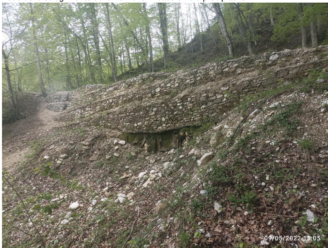
Figura 14 – Gabbionata di sostegno della pista forestale – da notare la sottoescavazione al piede ed il Tessuto Non Tessuto a vista
