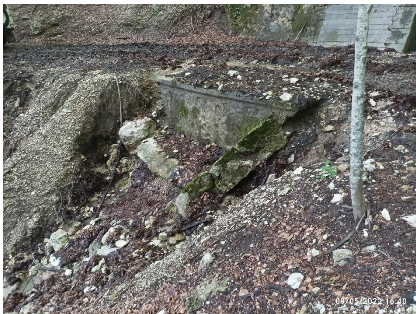
Figura 56 - Soletta stradale: erosione laterale ed al piede
