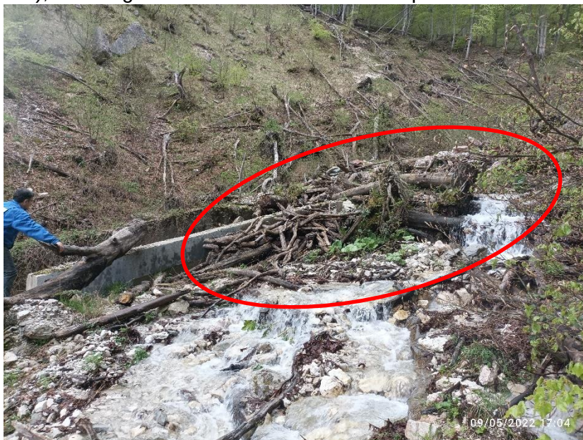
Figura 64 – Muro in sinistra idraulica parzialmente sepolto: da mettere a giorno ed eventualmente prolungarlo
