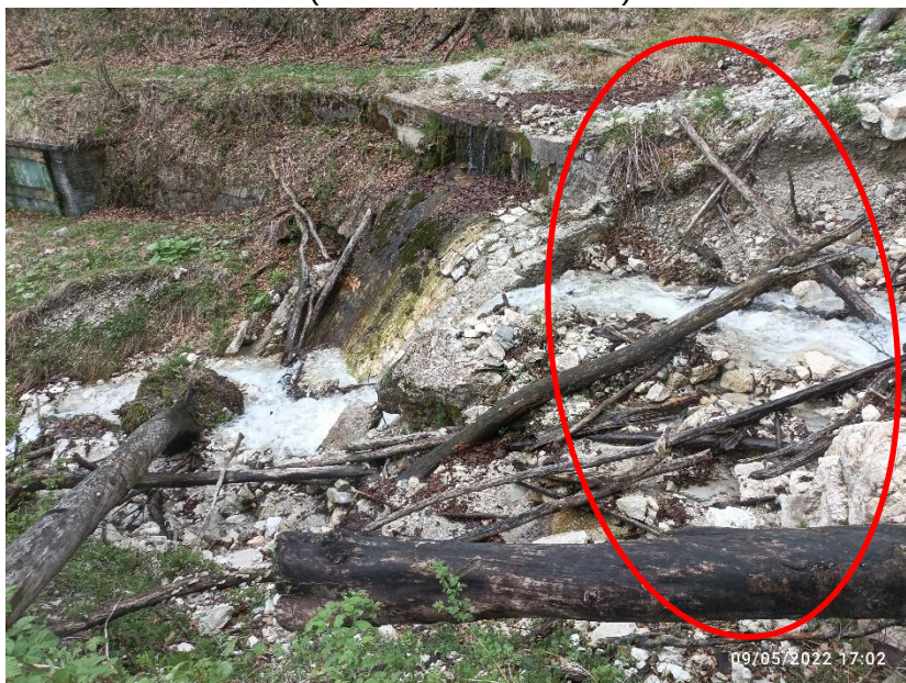
Figura 65 – Tratto di strada da ripristinare – vista da monte
