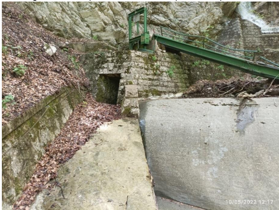
Figura 31 - porzione dell'OP priva di parapetto – a destra della foto la passerella divelta dal dissesto
