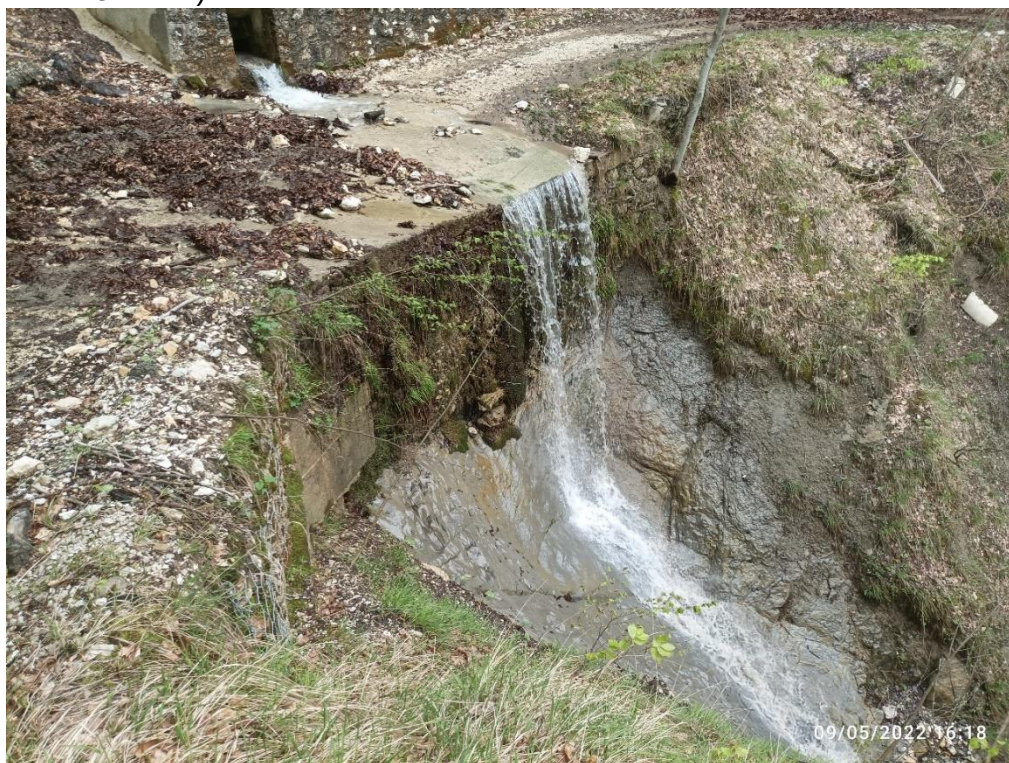
Figura 22 - erosione al piede della soletta e gabbione deformato
