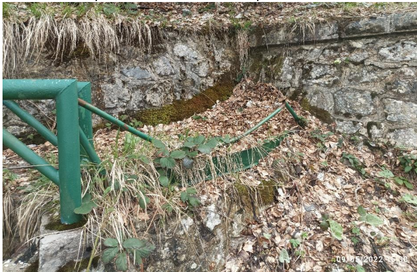
Figura 72 – Parapetto da ripristinare nei pressi della paratoia
