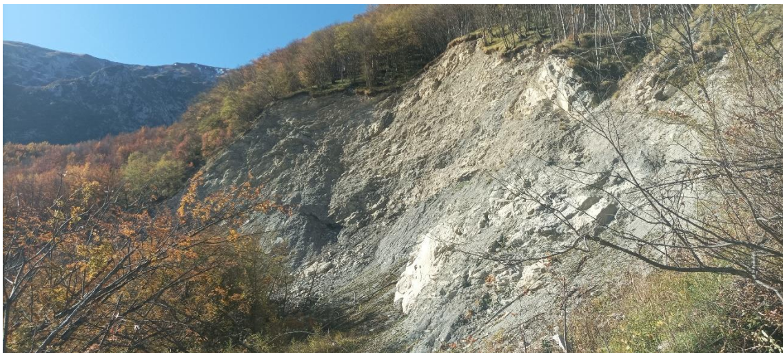
Figura 12 - Fronte della frana che ha distrutto una parte di canale – in periodi di asciutta non sono presenti ruscellamenti superficiali
