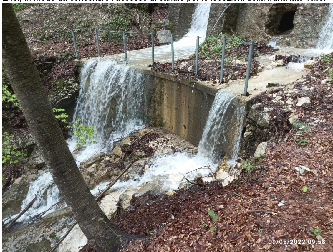
Figura 27 - OP San Nicola 1 dettaglio della breccia aperta nel canale di gronda e materiale solido accumulato
