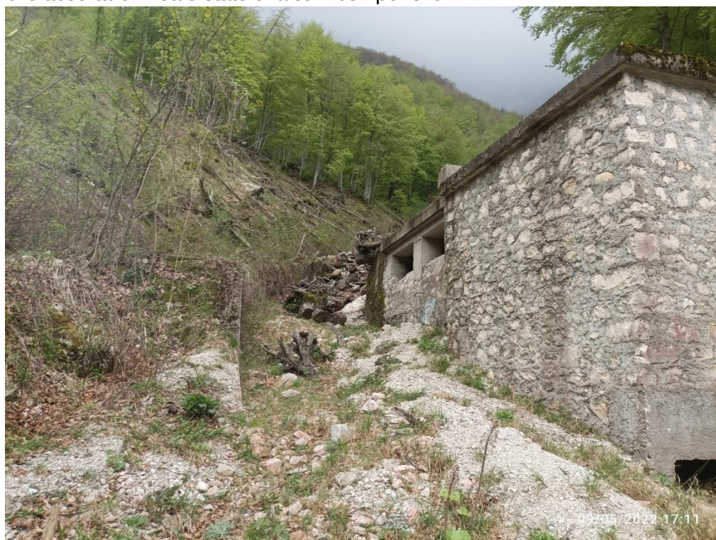
Figura 20 - lato destro dell'edificio dell'OP Fiumette, riempimento del vecchio corso d'acqua da parte del detrito trasportato dalla valanga
