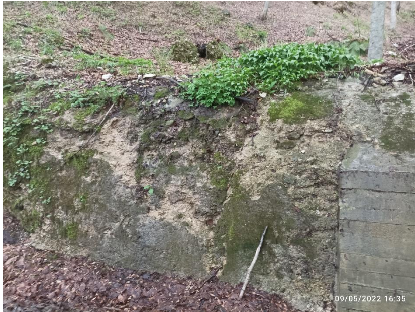
Figura 55 - Canale di gronda: rivestimento eroso
