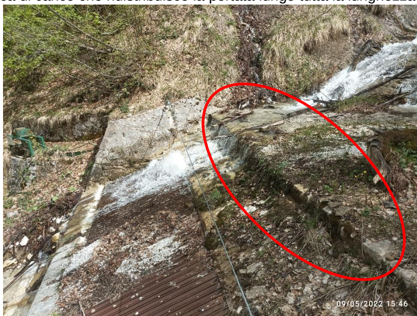
Figura 70 – Accumulo di sedimenti e cordolo di pietrame sommitale alla griglia di intercettazione
