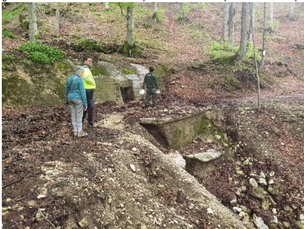
Figura 16 – Visione d'insieme della gronda corticale ammalorata e della soletta erosa al piede
