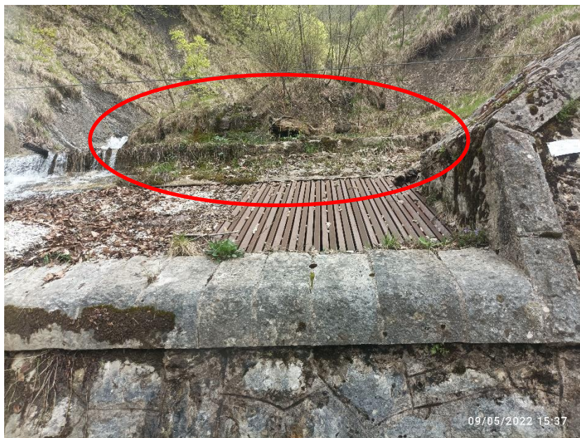
Figura 69 – Accumulo sedimenti in sinistra idraulica nell'alveo di monte – particolare dell'area in cui lo scorrimento del torrente è impedito
