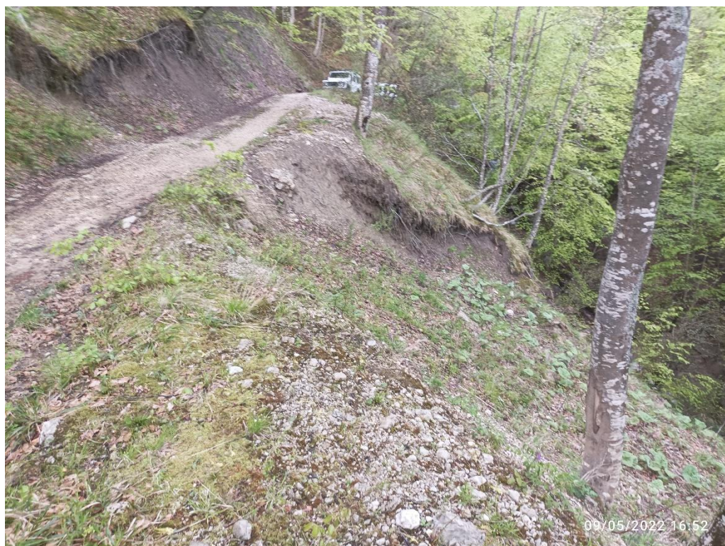
Figura 108 – Dissesto sulla pista forestale all'interno del territorio del Parco
