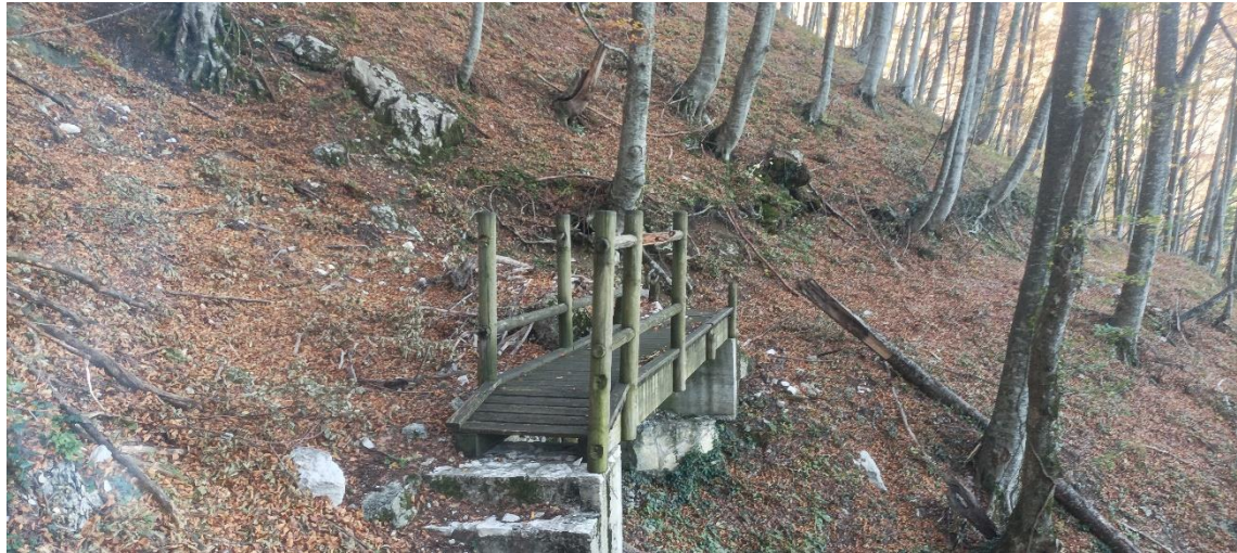
Figura 115 – Passerella ammalorata e parzialmente distrutta nei pressi di un impluvio
