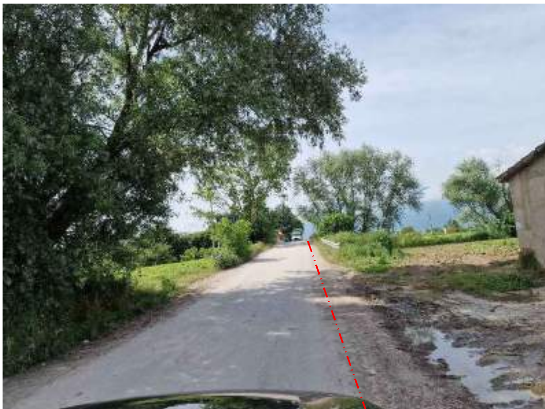
FOTOGRAFIA 6 - Strada 39 (Comune di Avezzano)
