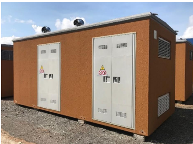
Figura 26 – Cabina di sezionamento
