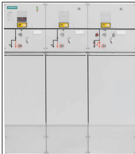
Figura 6 – Vista del quadro elettrico in MT
