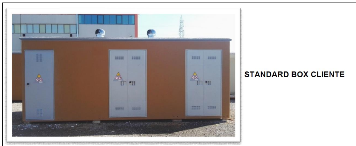
Figura 7 – Vista frontale della cabina di consegna tipo
