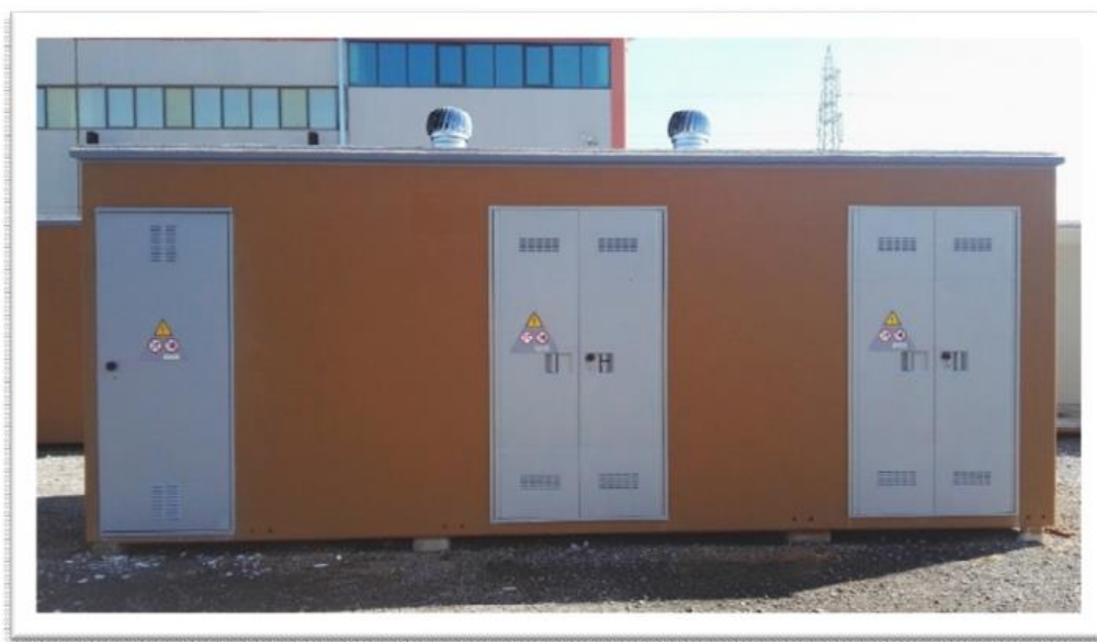
Figura 7 – Vista della cabina di consegna tipo
