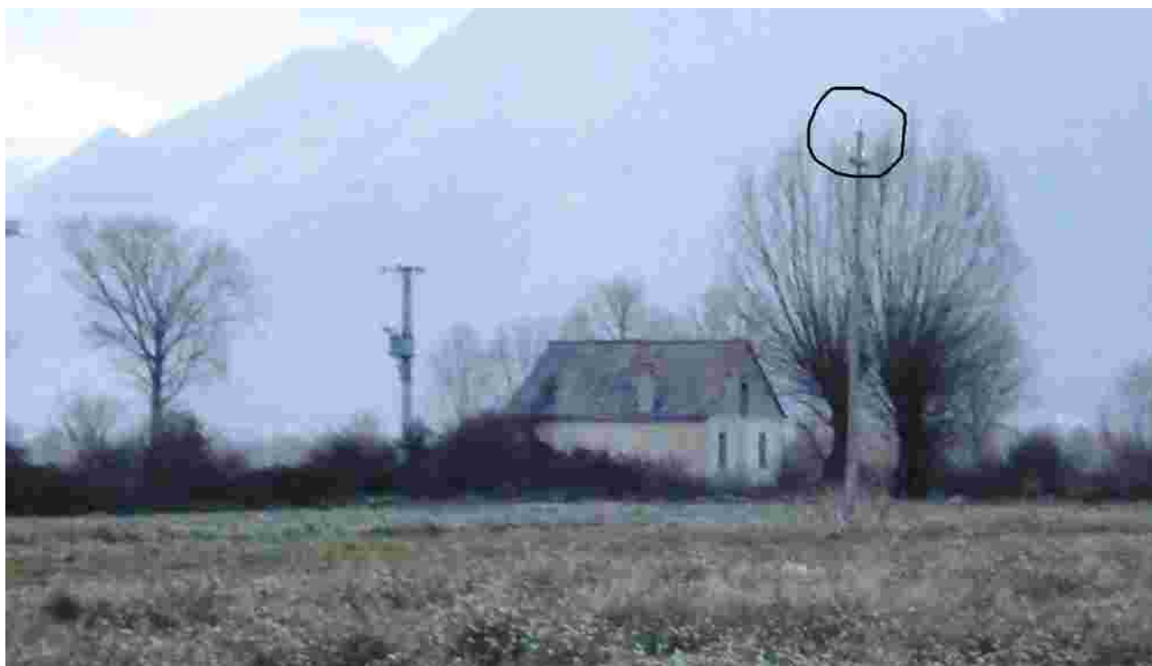
Foto 3: punto di connessione alla rete elettrica direttamente sul campo
