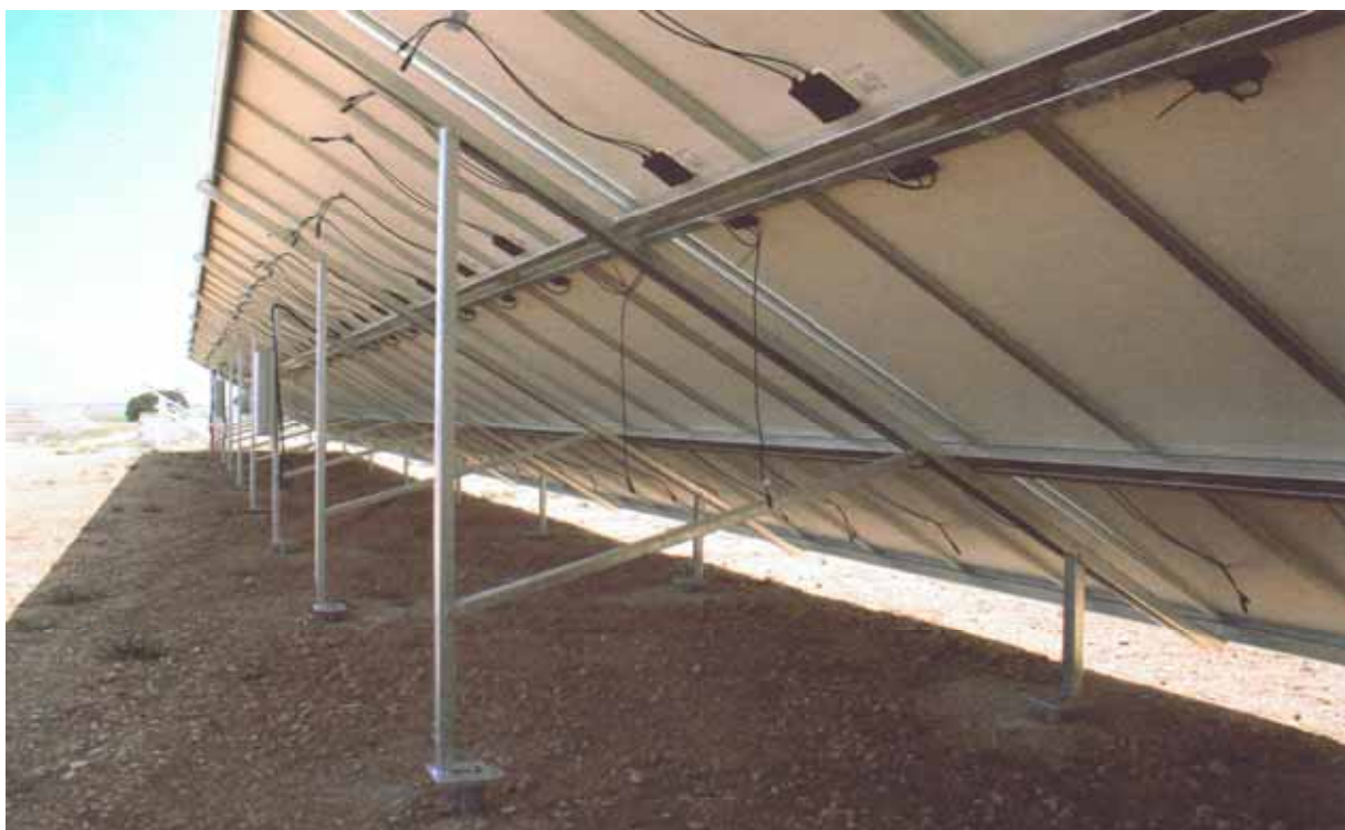
Figura 4.6 - Telaio a profilati in acciaio zincato orientato a sud e inclinato di 30°
