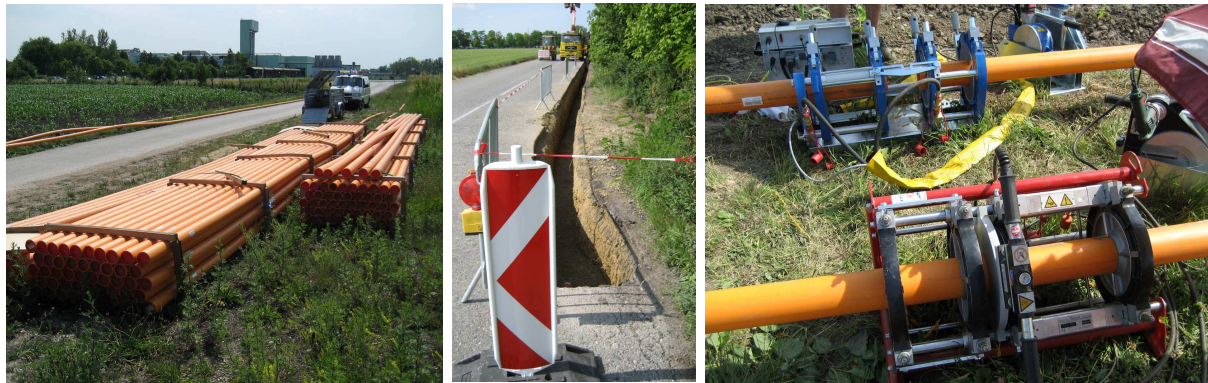
Figura 10: Condotta di Biometano in costruzione presso Bruck/Leitha, Austria; Fonte: Vienna University of Technology
