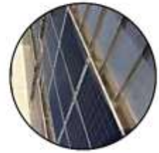
Copertura con moduli fotovoltaici
