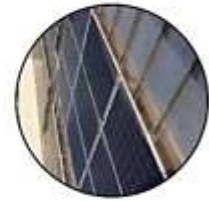
Copertura con moduli fotovoltaici
