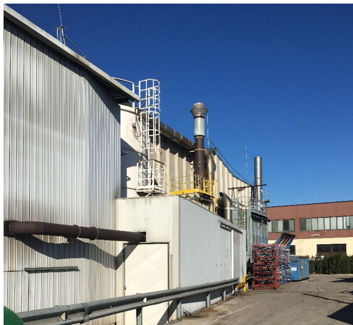
FOTO 13: IMPIANTO RIGENERAZIONE SABBIA
