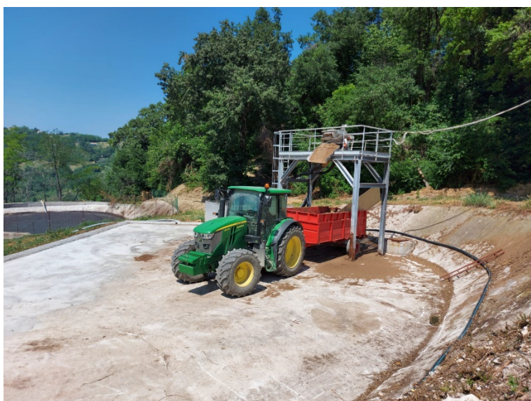
Rispristino separatore solido liquido
