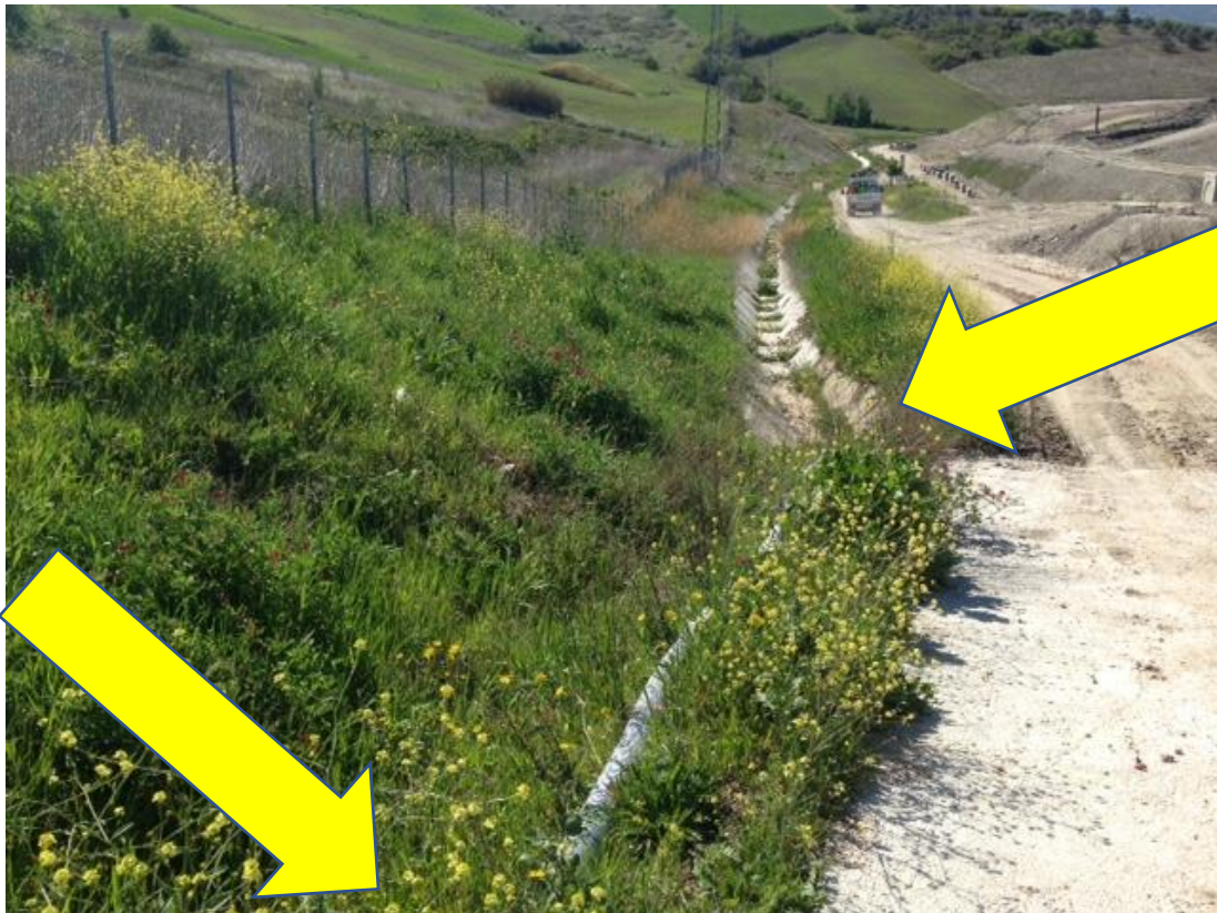
QUI SI VEDE IL TRATTO NON RACCORDATO
