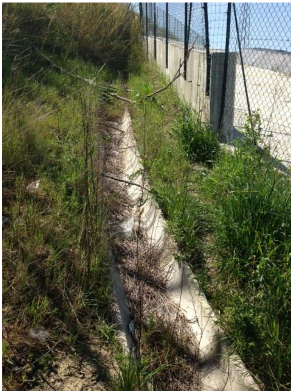
CANALIZZAZIONE IN PESSIMO STATO MANUTENTIVO
