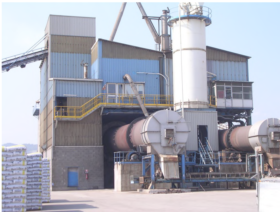
Figura 6: impianto di iniezione della dolomite
