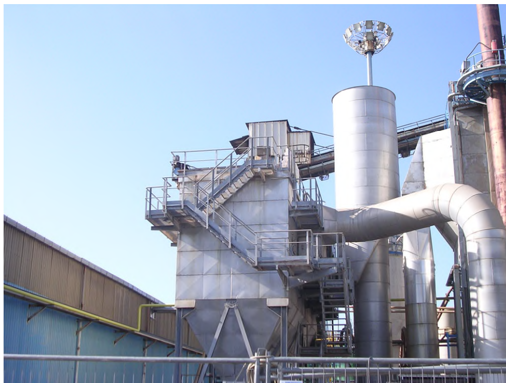
Figura 8: impianto per l'iniezione di bicarbonato di sodio in polvere fine
