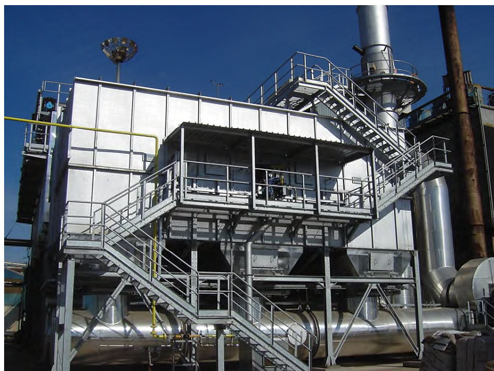
Figura 9: impianto di ossidazione termica
