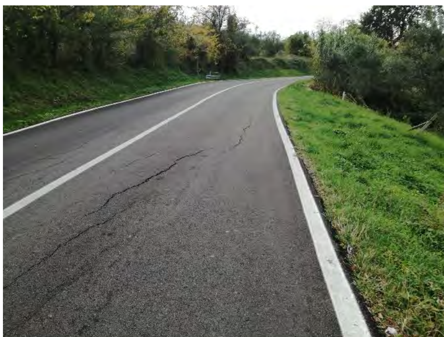
Figura 30 – Fessure trattive sulla sede stradale
