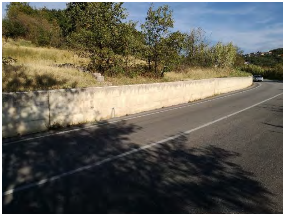
Figura 6 – Zona di sormonto delle acque di monte sui muretti esistenti
