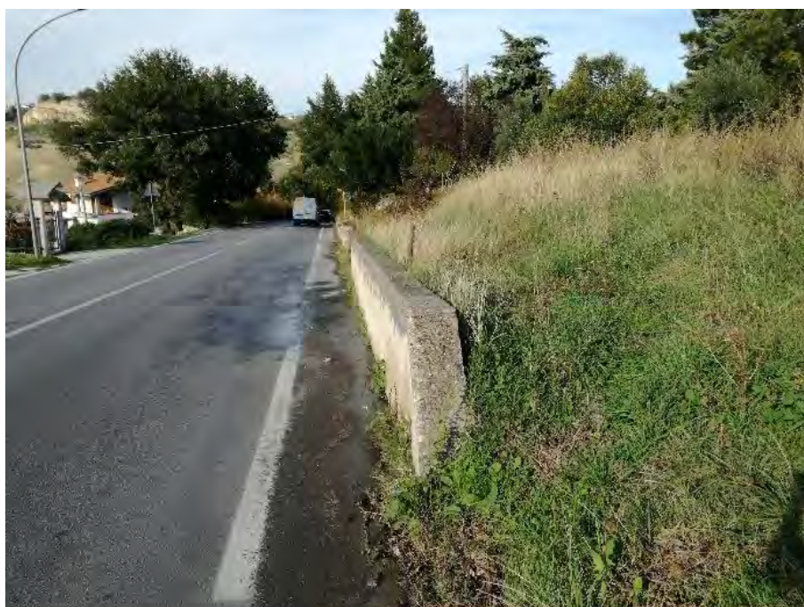
Figura 7 – Zona di sormonto delle acque di monte sui muretti esistenti
