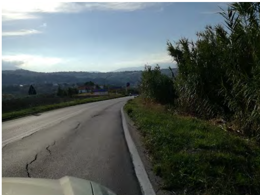
Figura 11 – Tratto rettilineo in dissesto. Presenza evidente di fessure trattive sulle sedi stradali
