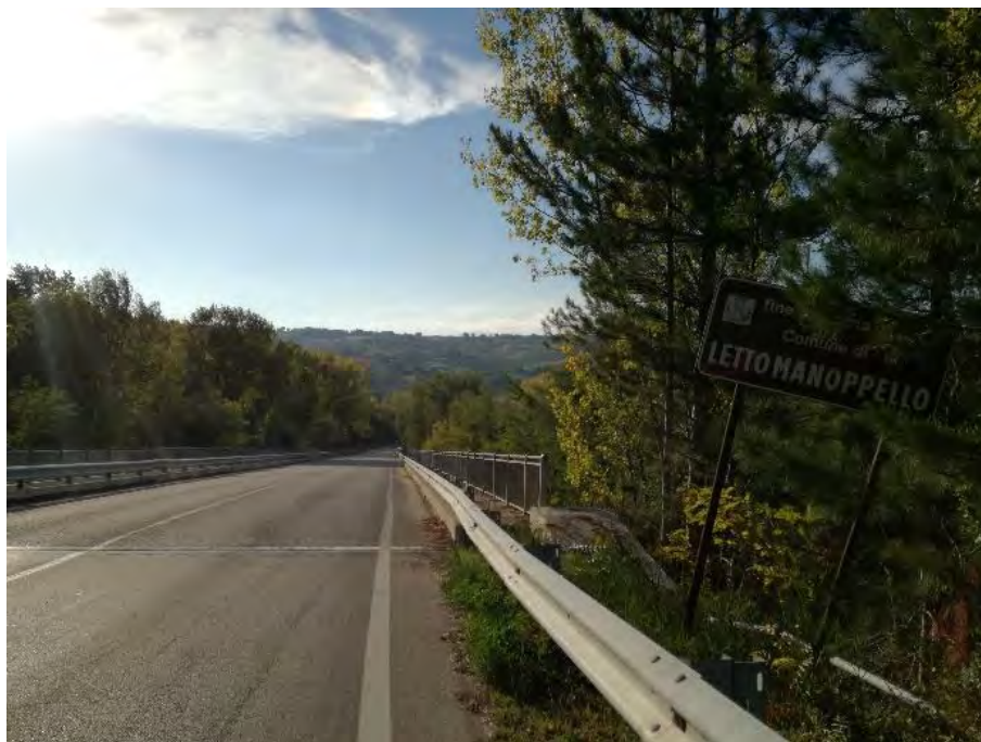
Figura 12 – Ponte della Maiella con giunti ammalorati
