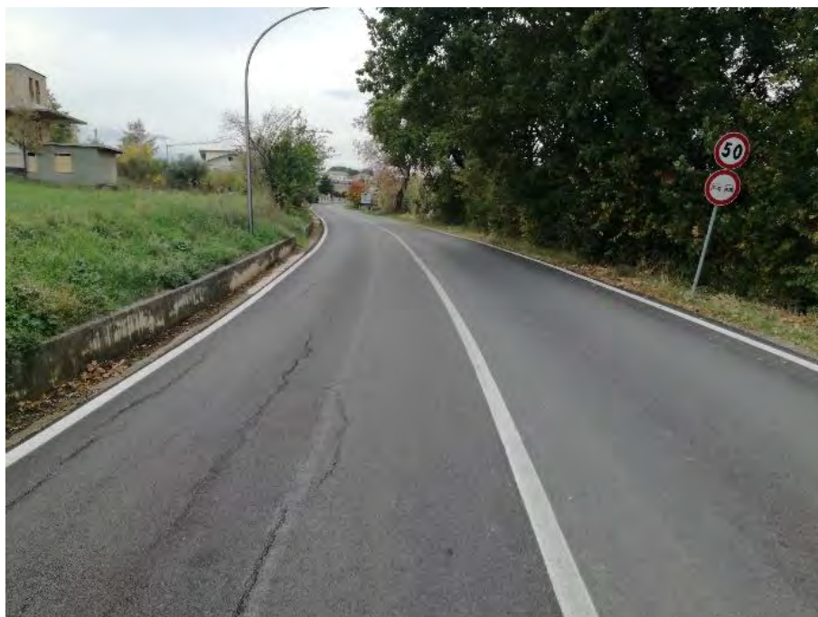
Figura 28 – Fessure trattive sulla sede stradale
