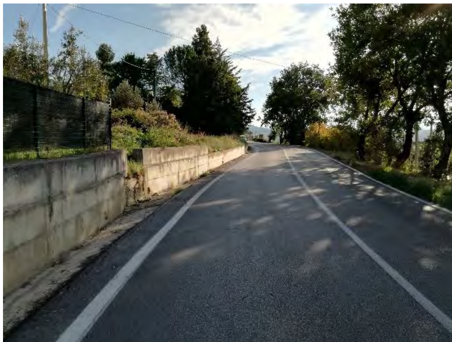
Figura 8 – Zona di sormonto delle acque di monte sui muretti esistenti
