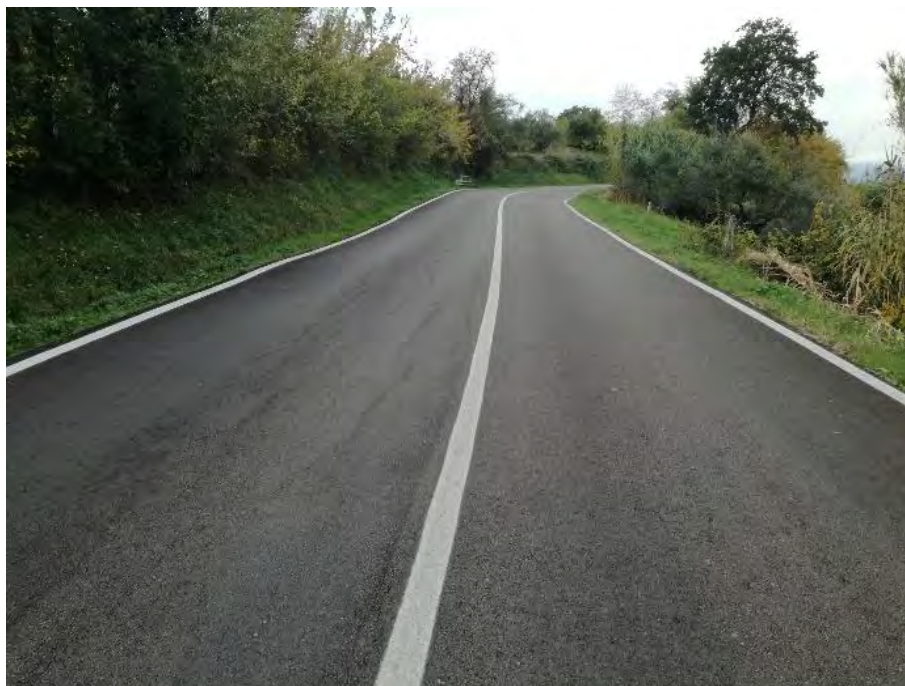
Figura 31 – Fessure trattive sulla sede stradale
