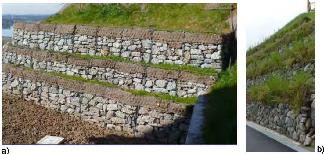
Figura 12 - Esempio di intervento in terramesh: a) in fase di realizzazione e parziale inverdimento. b) completamente rinverdita
