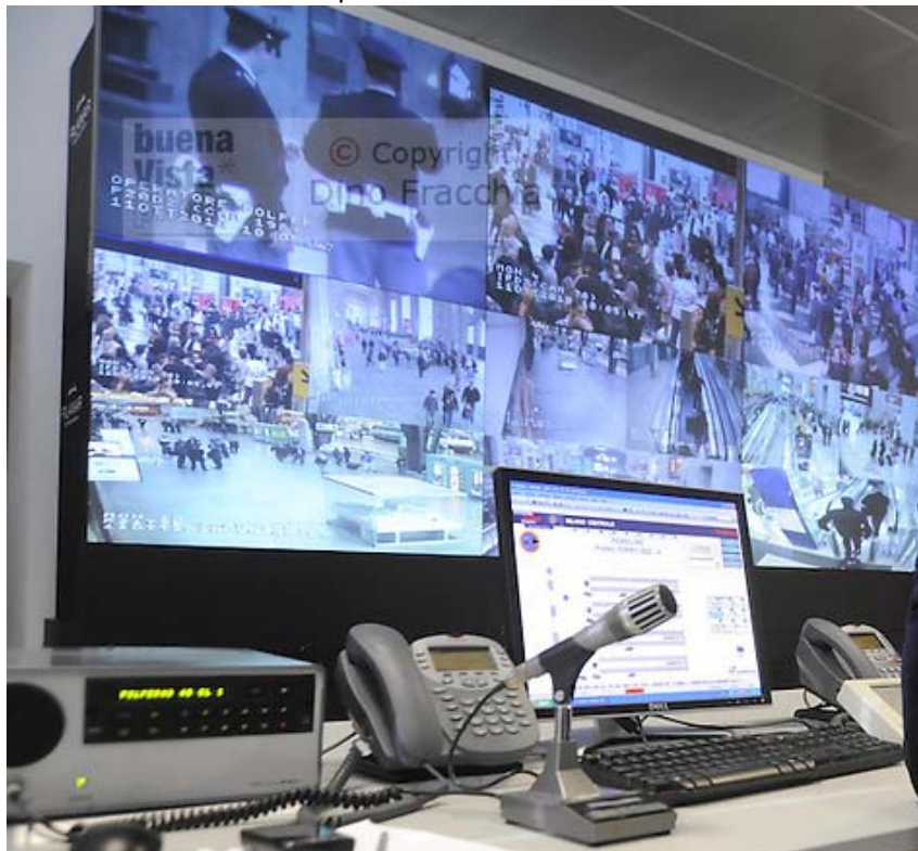
Foto Esempio di Contro Room realizzata:
