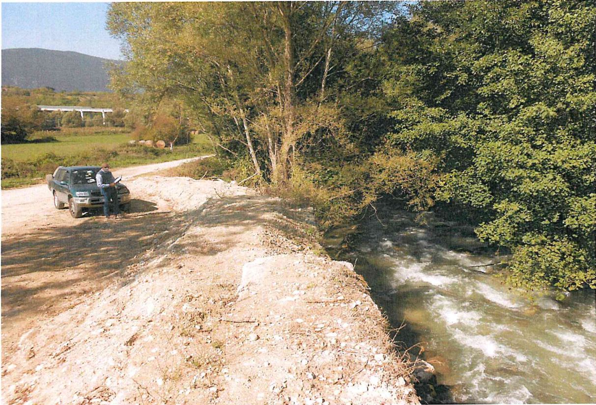
foto 3 vista del muro d'argine in sx idraulica danneggiato
