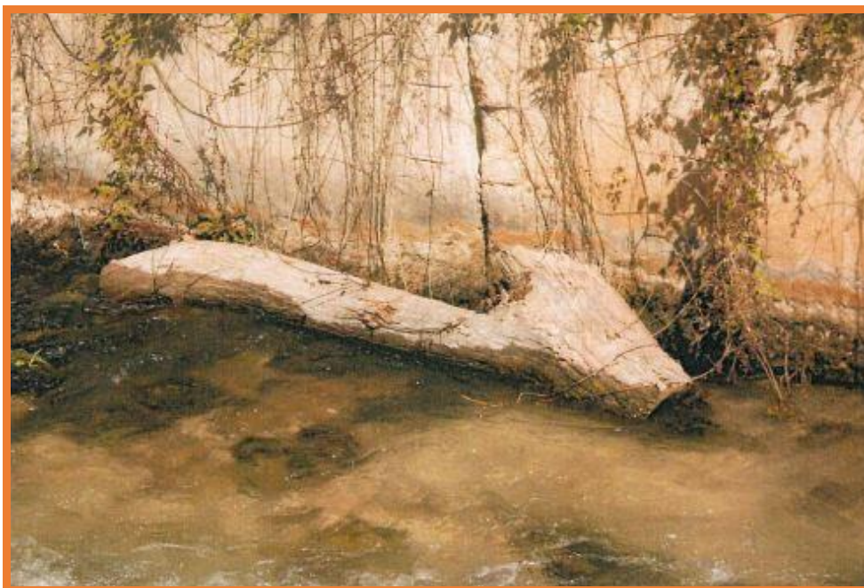
Figura 17 - Vista del Fiume con tronco da rimuovere
