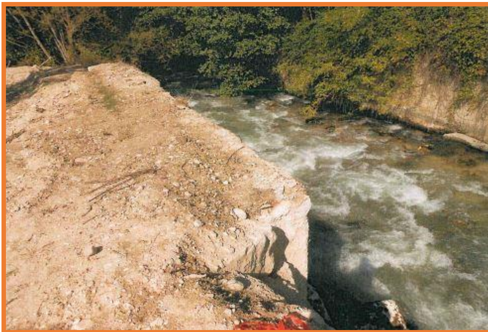
Figura 13 - STATO DI FATTO - Vista del muro d'argine in sx idraulica danneggiato
