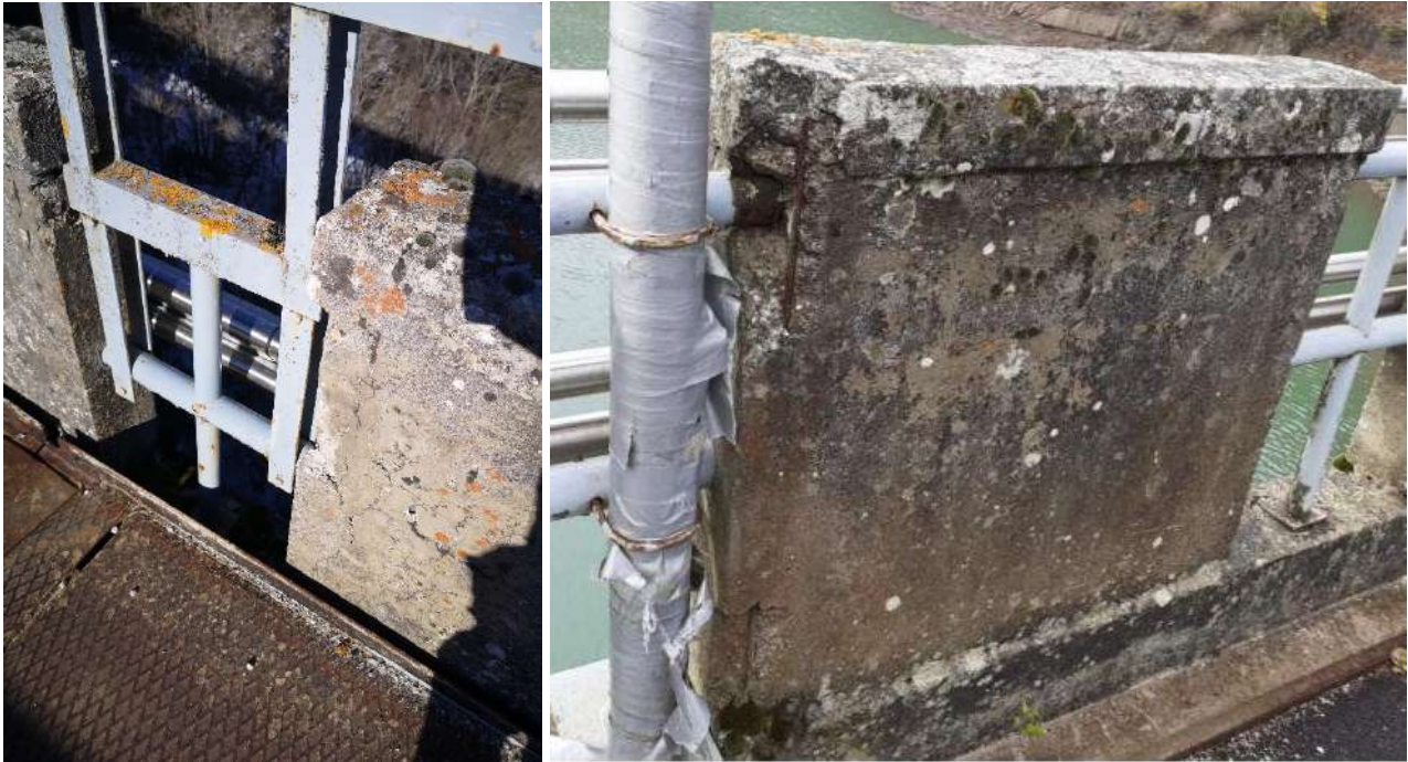
Foto 7,8 – Parapetti in calcestruzzo sul coronamento da risanare
