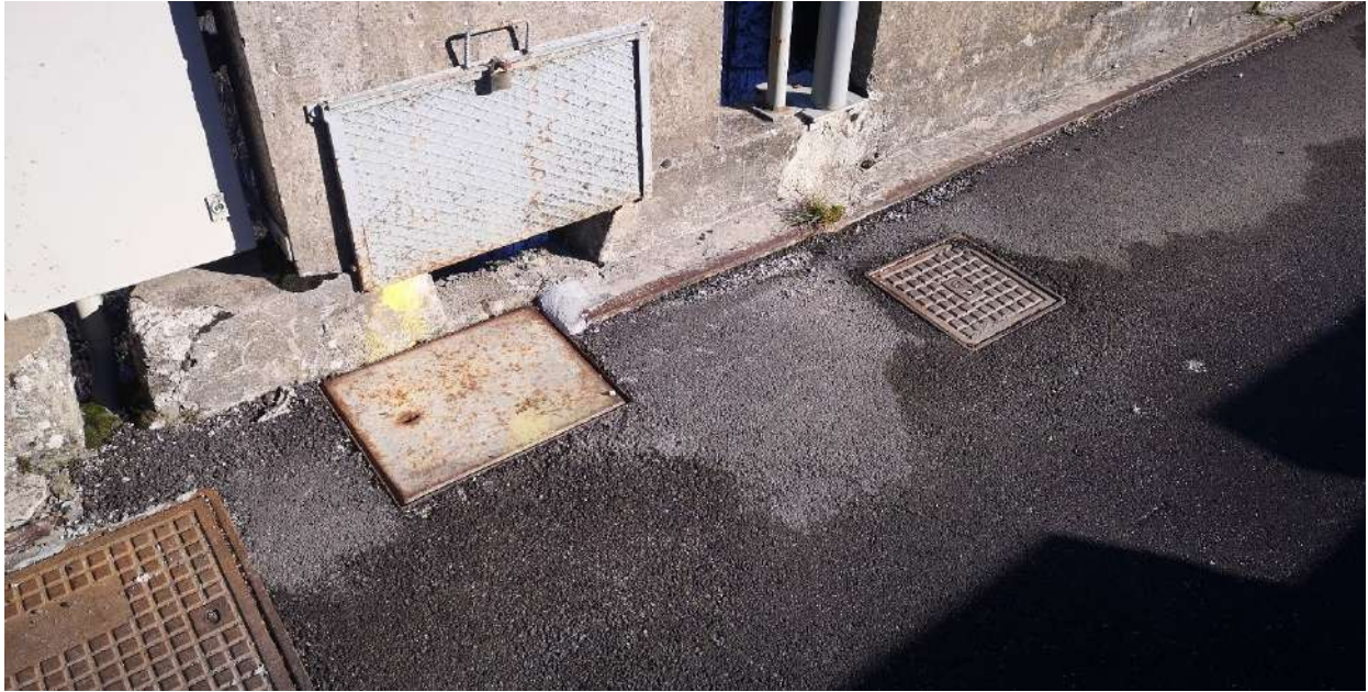
Foto 11 – Pozzetti da risanare
