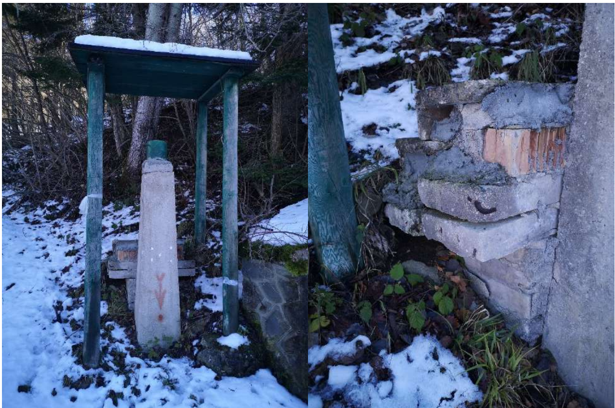
Foto 9,10 – Pilastrino di collimazione da risanare, ubicato in spalla destra
