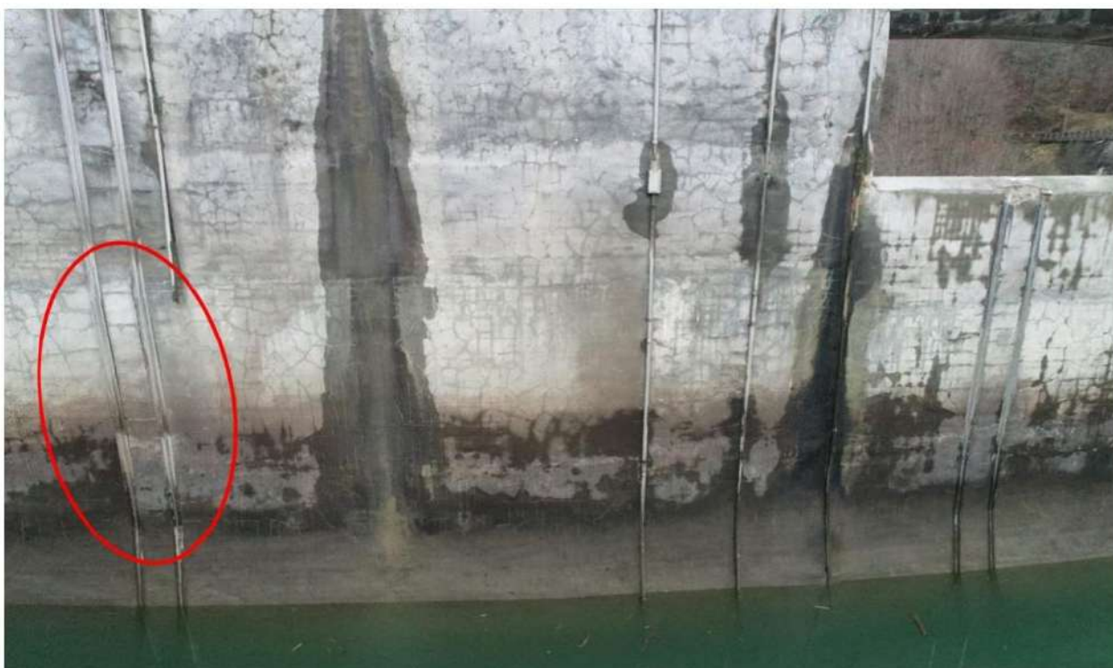
Foto 4 – Paramento di monte con evidenziati gli elementi coprigiunto deformati.
