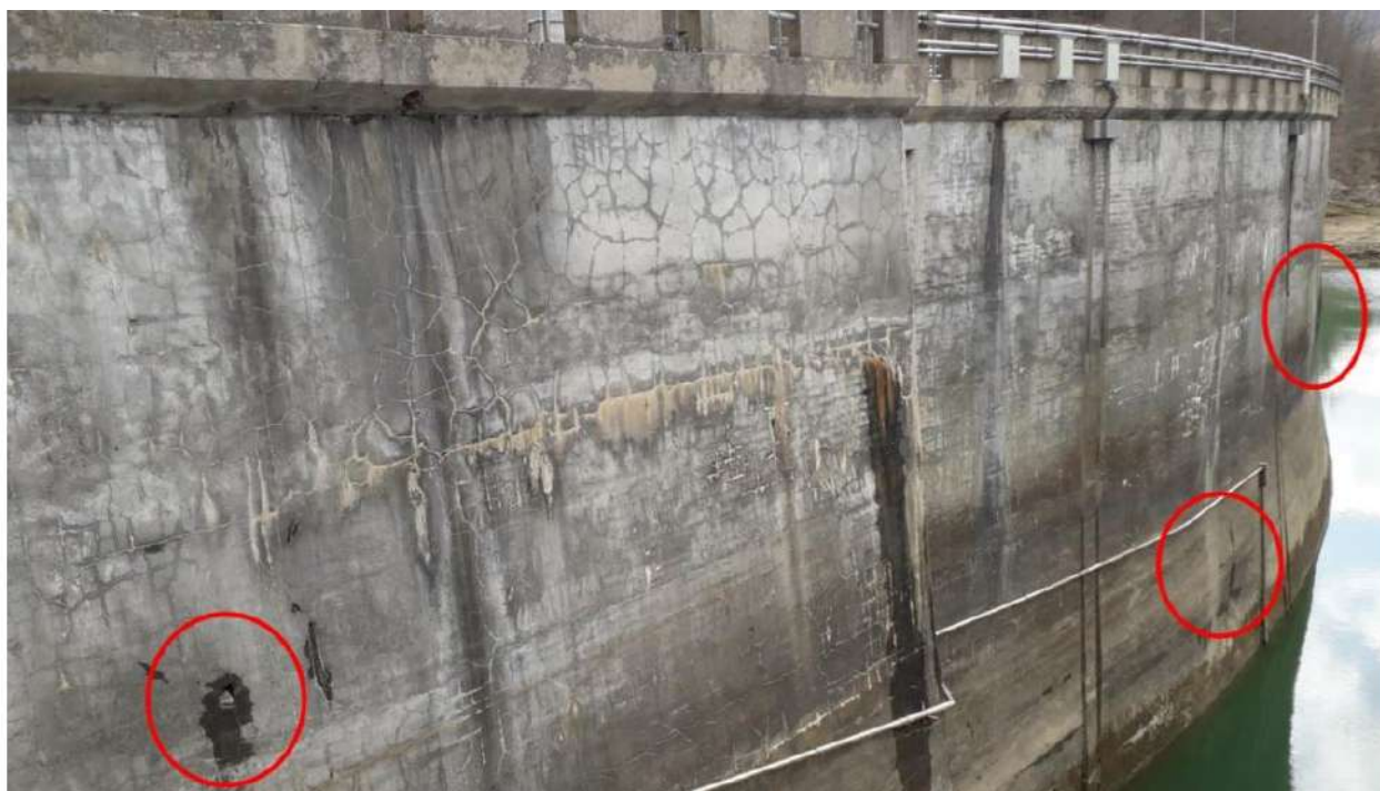
Foto 3 – Paramento di monte caratterizzato da visibili degradi e ragnatela di microfessure, con evidenziati alcuni rigonfiamenti e distacchi del rivestimento.
