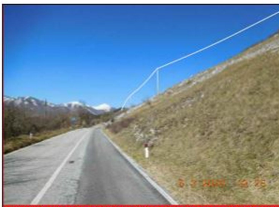
FOTO N. 1/BIS RICOSTRUZIONE LINEA MT, CON POSA DI NUOVO SOSTEGNO E CAVO AEREO
