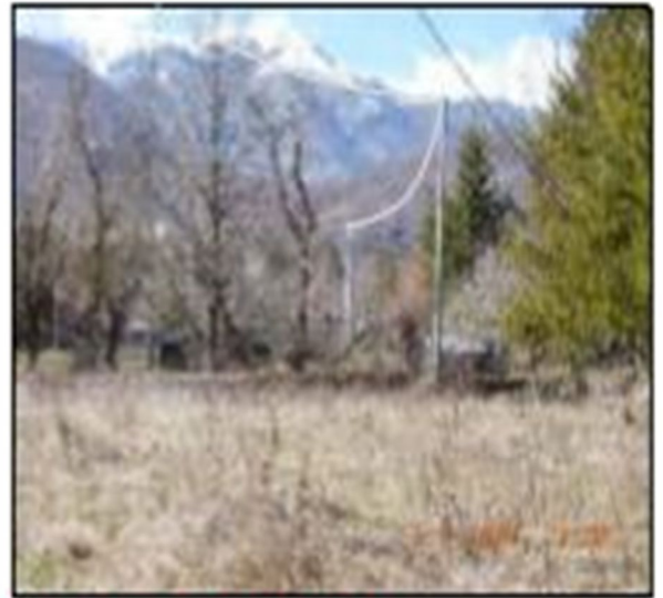
FOTO N. 5/BIS RICOSTRUZIONE LINEA MT CON POSA DI NUOVO SOSTEGNO E CAVO AFREO
