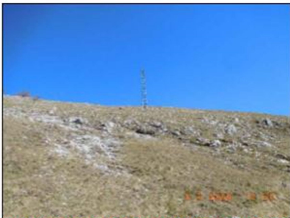
FOTO N. 2 LINEA MT AEREA ESISTENTE COMPOSTA DA: TRALICCI E CONDUTTORI NUDI
