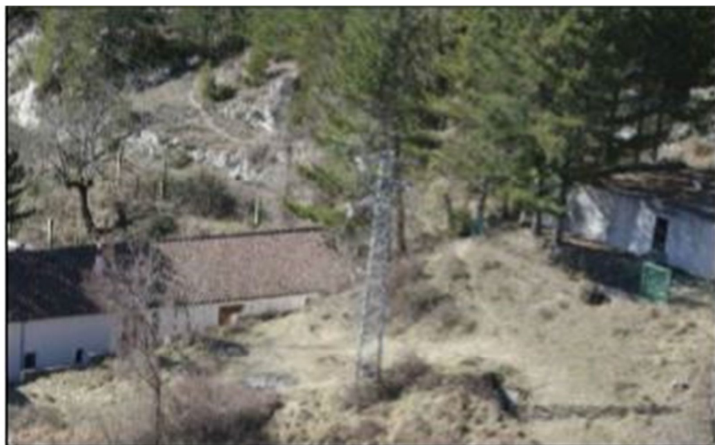
FOTO N. 1 TRAL. ESISTENTE, CONDUTTORI NUDI TRANSITO SU COPERTURA ABITAZIONE
