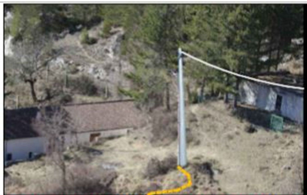
FOTO N. 1/BIS FINE TRATTO AEREO PROVENIENTE DALLA C.P. INIZIO TRATTA IN CAVO INTERRATO FINO ALLA CAB. REGINA
