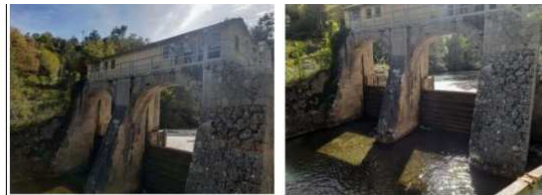
Figura 7 - Paratoie dell'Opera di presa
