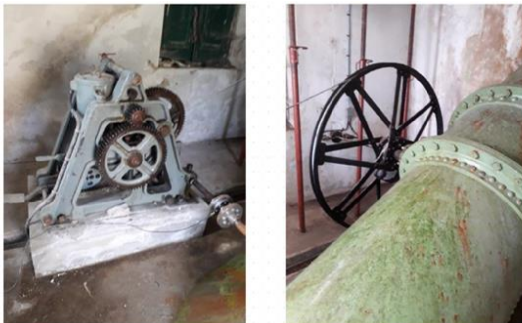
Figura 6 - Valvola a farfalla da sostituire
