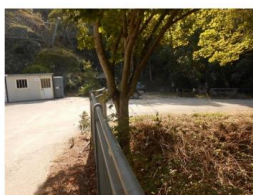
Foto n. 10 Particolare di pianta di acero vegetante e ridosso dello spallo destro del ponte in territorio di Molina Aterno che verrà tagliata
