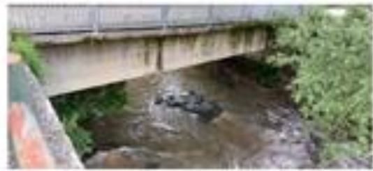
Foto 1-4-5 Comune di Molina - Ponte di San. Nicola Aterno - stato dei luoghi nel Giugno 2023
