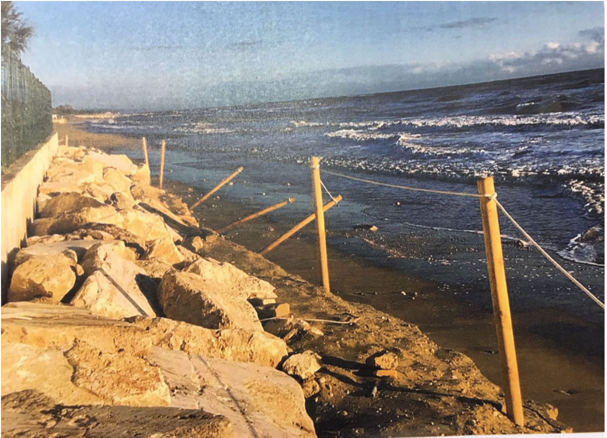
Fig. 2.4 Stato del litorale dopo le mareggiate del novembre 2019 – febbraio 2020
