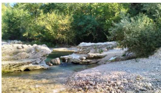
Rottura della briglia – foto scattata da monte
