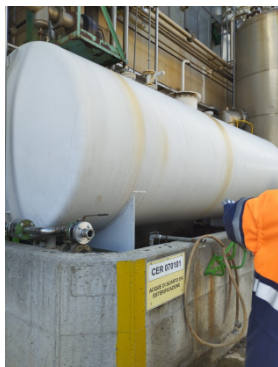
Foto 6. Zona B deposito EER 070101*
