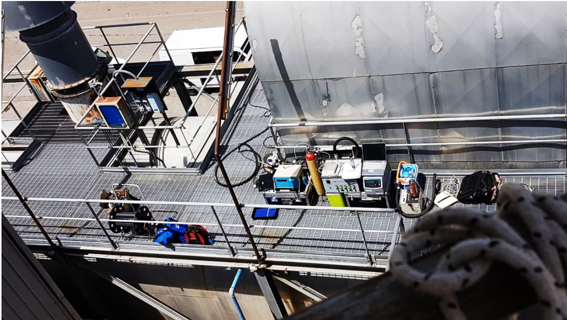
FOTO 1: STRUMENTAZIONE UTILIZZATA PER IL CAMPIONAMENTO DELLE EMISSIONI AL CAMINO 95 V
