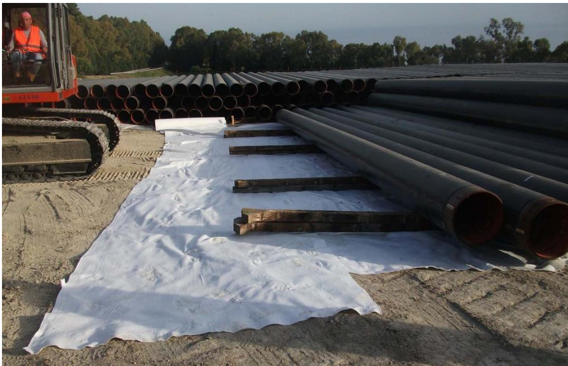
Fig. 8-1 - Piazzola di accatastamento tubazioni
