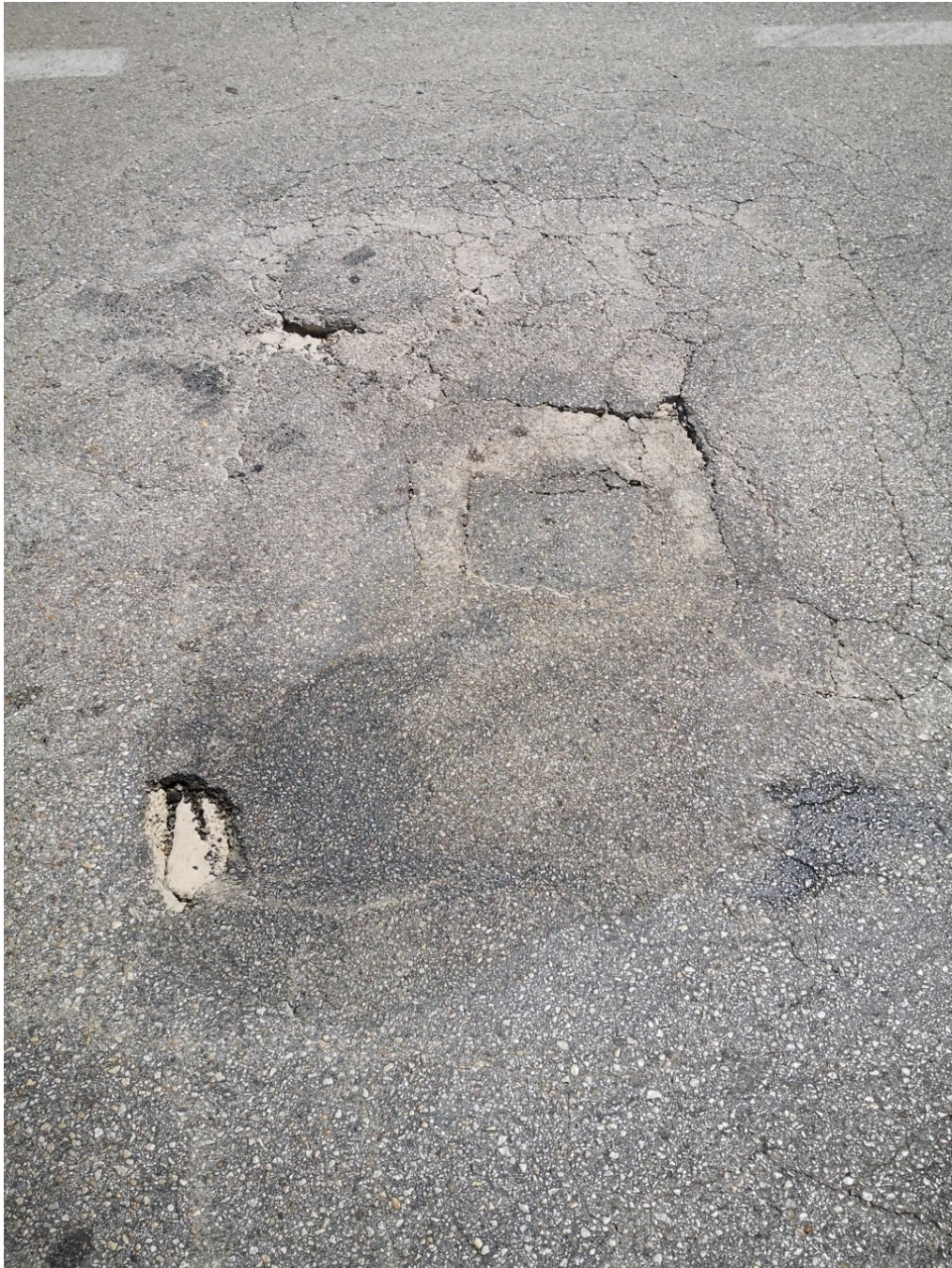
Foto 3: S.P. Trignina - Contrada Piane Sant'Angelo ubicazione pozzetto P.I.L.13298/2 interrato da rimuovere
