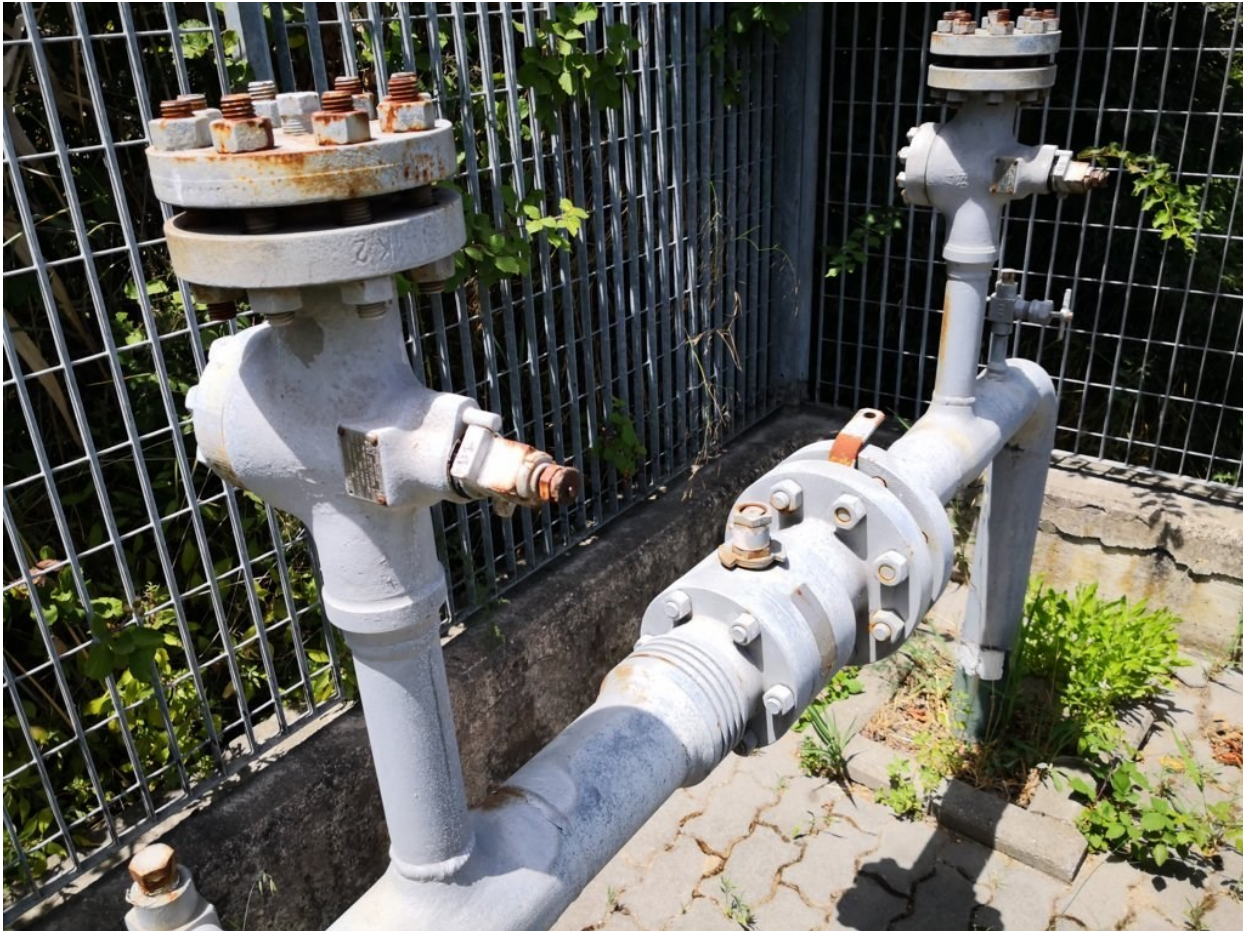
Foto 6: particolare P.I.D.A. n. 4160466/1 da rimuovere
