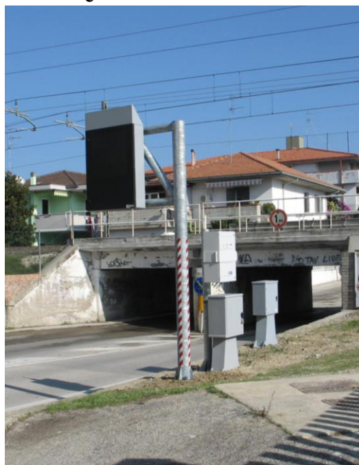
Figura 33 Sistema di monitoraggio e allarme dei sottopassi
