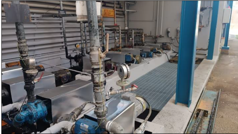
FIGURA 2: ZONA POMPE RIPULITA, CON EVIDENZA DELLA CARTERATURA.
