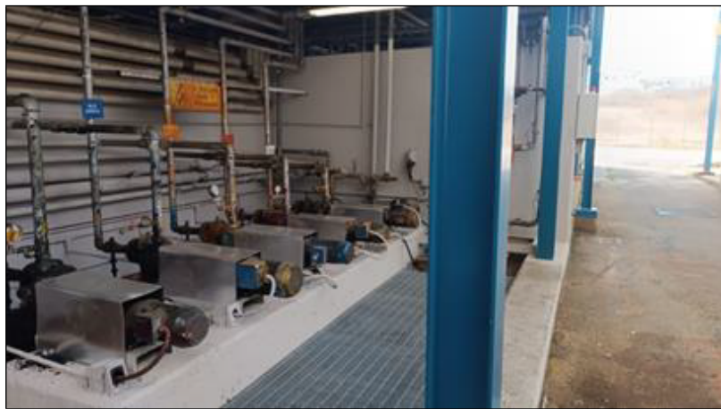
FIGURA 3: ZONA POMPE RIPULITA, CON EVIDENZA DELLA CARTERATURA.
