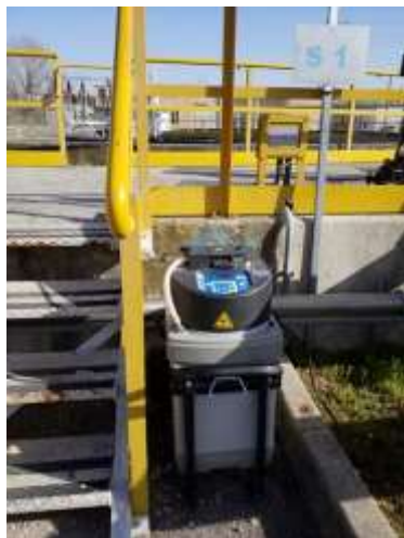
Foto 2: pozzetto di ispezione uscita trattamento
