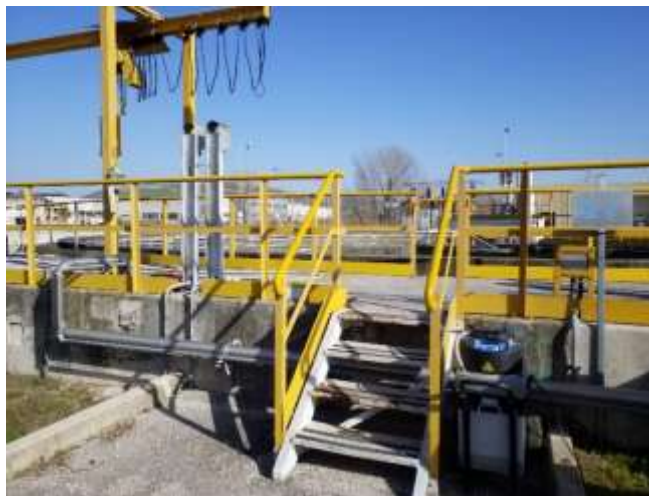
Foto 3 S1 uscita del depuratore.
