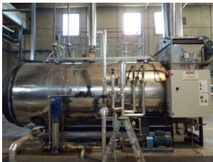
Foto 9: caldaia per la produzione di vapore sottesa a E10
