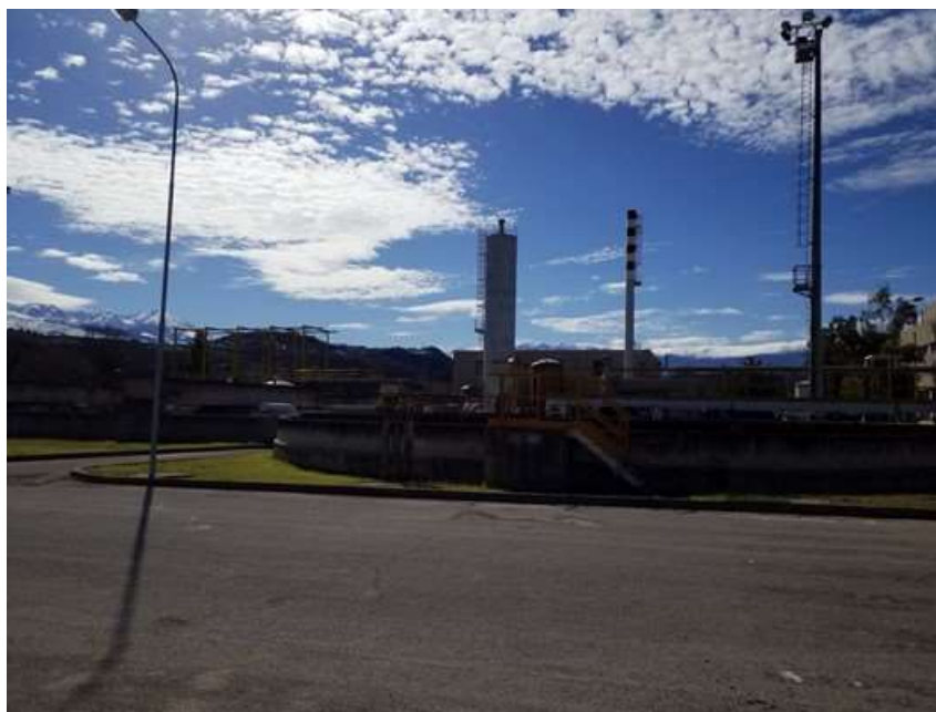
Foto 1 impianto di depurazione chimico-fisico
