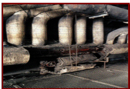
Rivestimento isolante in gesso e amianto
