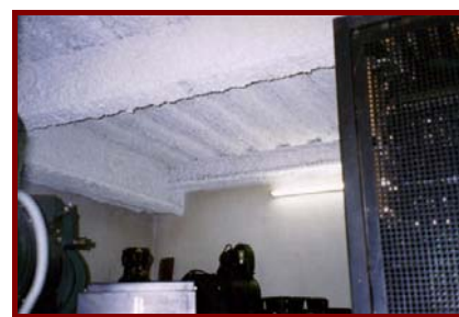
Amianto spruzzato: crocidolite su struttura metallica
