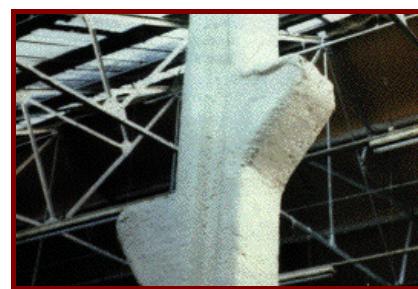
Amianto spruzzato: crocidolite su pilastro
