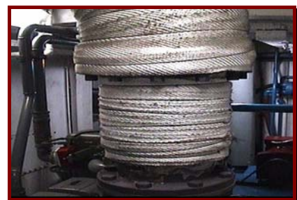
Tubazione con rivestimento isolante
